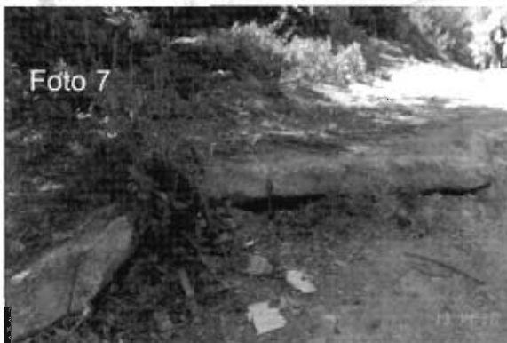
Fotos 6 y 7. La imagen de la foto 6, fue tomada entre los puntos 3-3'. Obsérvese el agrietamiento del terreno a consecuencia del movimiento del bloque deslizante. La foto 7, correspondiente a la calle Ampliación María Bonita, se observa el desnivel del terreno, en el cual existen aproximadamente 18 cm de separación
