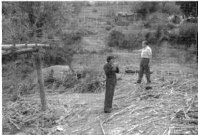
Foto 19. Aquí se observa la zona de fracturamiento (escarpe principal) en la parte alta del bloque (corona) en proceso de deslizamiento en San Miguel Laderas. Por éste escarpe y fracturas asociadas se filtra el agua de lluvia, provocando una "tasa" mayor de deslizamiento, sobre todo durante el verano
