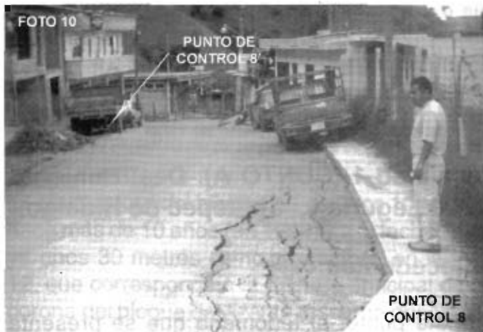
En la imagen 10, se puede observar la ubicación de los puntos de control 8-8', así como el segmento de la carpeta asfáltica de la Av. Independencia que resultó afectado por el asentamiento y desplazamiento pendiente abajo del sector de terreno próximo a deslizarse. La imagen fue tomada viendo hacia el norte
