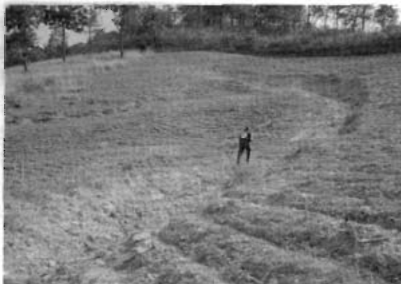
Foto 21. Zona de desconchamiento en forma de herradura, en el deslizamiento dentro de la jurisdicción de la comunidad Los Naranjos
