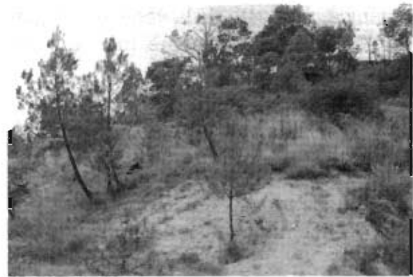
Foto 17. Terreno y árboles desplazados por el bloque en proceso de deslizamiento, desde finales de octubre del 2001
