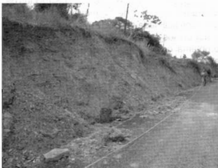
Foto 18. Tramo carretero de 47.5 m, que abarca la base del bloque deslizante. Obsérvese a la izquierda los constantes derrumbes por el avance del terreno hacia la carretera
